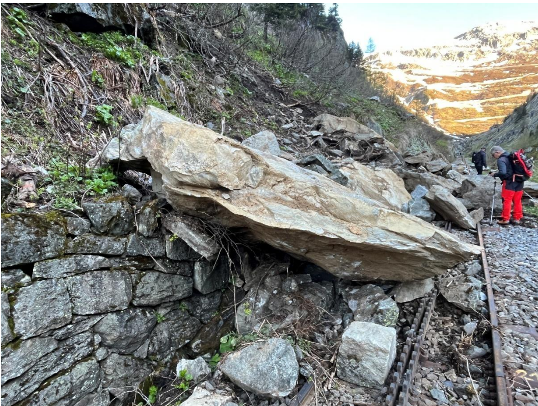
Die beschädigte Trockenmauer. Bild: Patrick Smit
