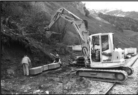
Böschungsabtrag in der Geren
