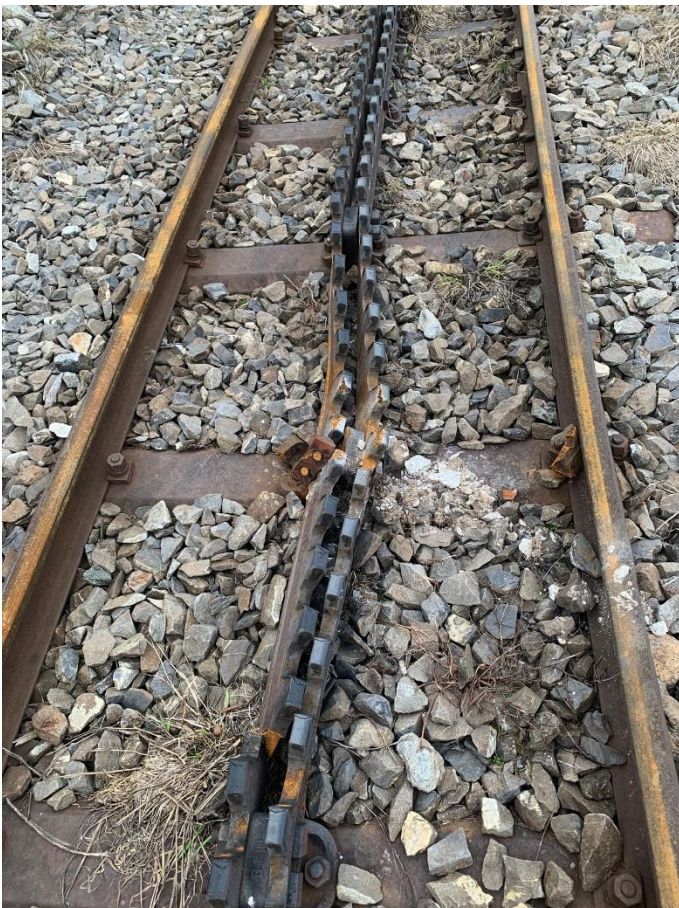
Gleisschaden zwischen Bahnübergang Bogen und La- winenschutzdamm oberhalb von Oberwald.
