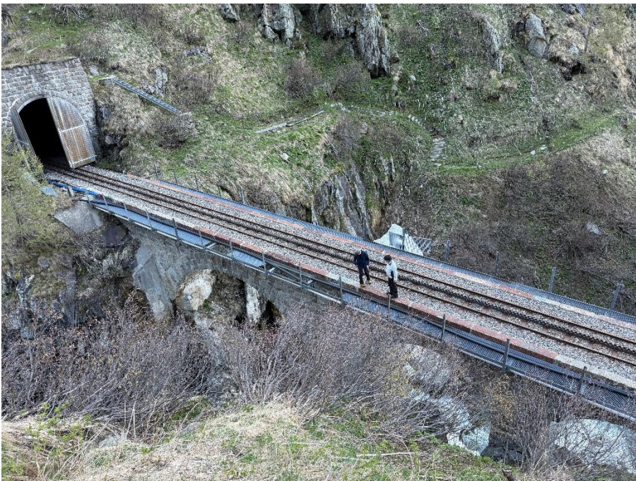
Patrick Smit und Bernhard Lang inspizieren die Schäden der Laufgitter des Rottenviadukts. Der Schliessmechanismus des rechten Tunneltors wurde wahrscheinlich von der Staublawine verbogen. Aus diesem Grund kann das rechte Tunneltor zurzeit nicht in der Sommerstellung arretiert werden. Bild: Andreas Kleeb.
