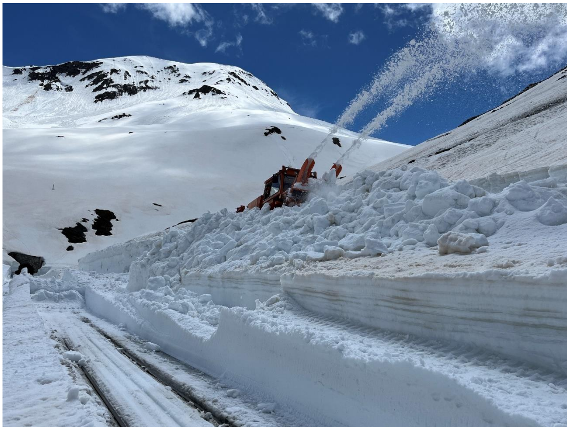
Während Stephan Stauber an der Ostseite des Bahnhofs Furka fräst, ... Bild: Patrick Smit
