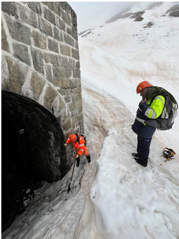
Andreas Simmen, Bruno Zimmermann und Patrick Smit steigen in den Scheiteltunnel, um beidseitig die Tunnel Tore zu öffnen.
