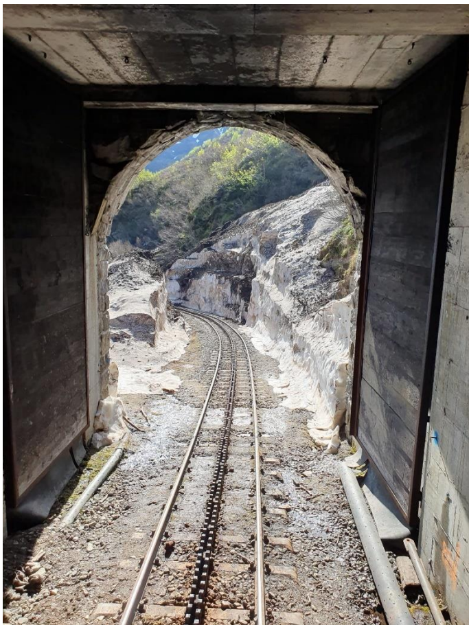
Blick vom talseitigen Portal des Tunnels 2 Richtung Tunnel 3. Vor etwas mehr als einer Woche kämpften wir hier durch meterhohe Geröll-, Erd- und Schneemassen.
