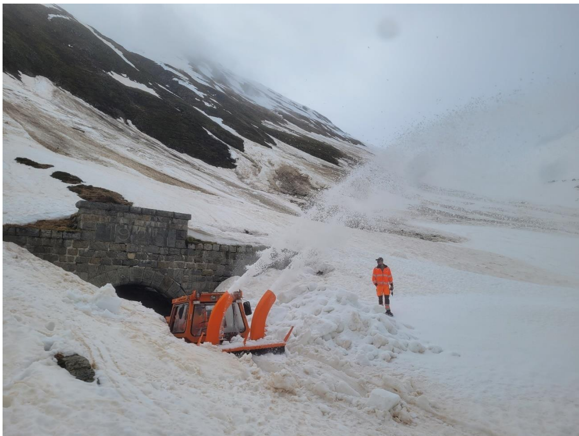
Am Westportal angekommen, fräst sich Thomas Holder ins Freie. Bild: Eric Fornallaz
