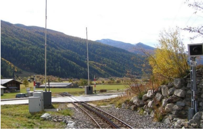
Bahnübergang Bogen Oberwald
