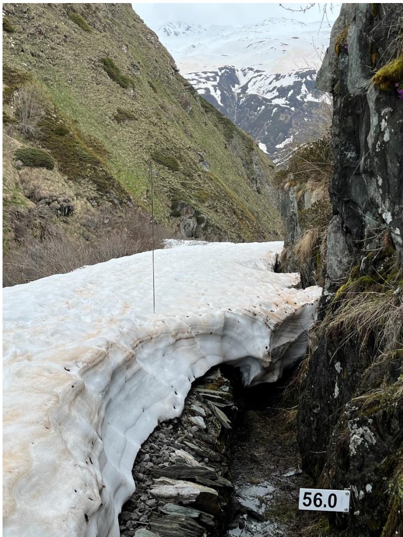
Zwischen Steffenbachbrücke und Steinsäumli liegt auf dem Bahntrasse max. 70 cm Schnee.
