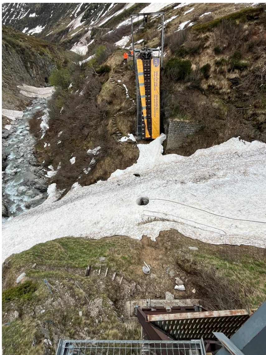
Dank der warmen Witterung der letzten Tage ist das Lichtraumprofil für das Aufstellen der Steffenbachbrücke nur an wenigen Ort noch knapp verletzt.
