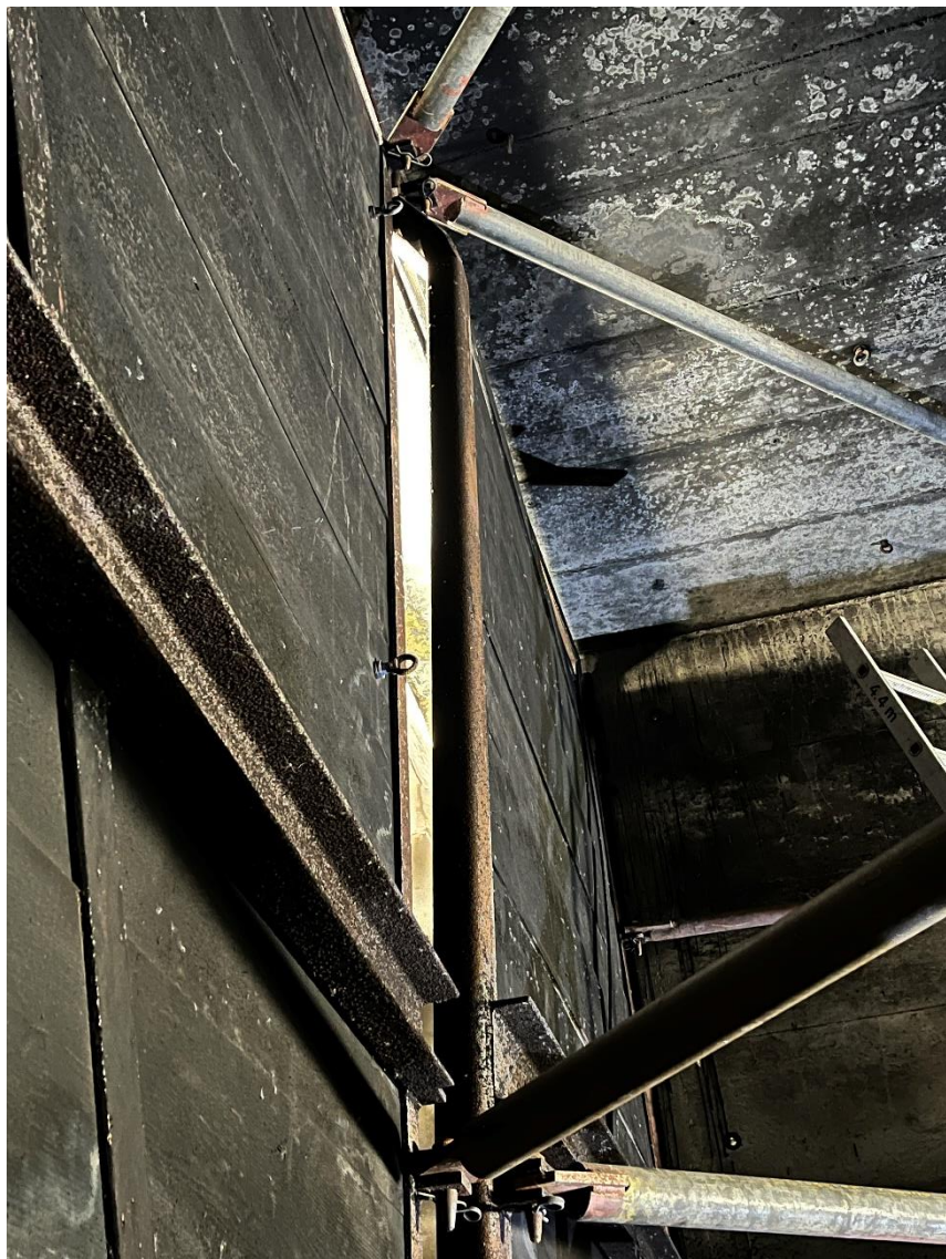
Eine Lawine hat den talseitigen Flügel des bergseitigen Tors des Tunnels 1 eingedrückt. Der oberste Spriess wurde hierbei verbogen. Bild: Patrick Smit,
