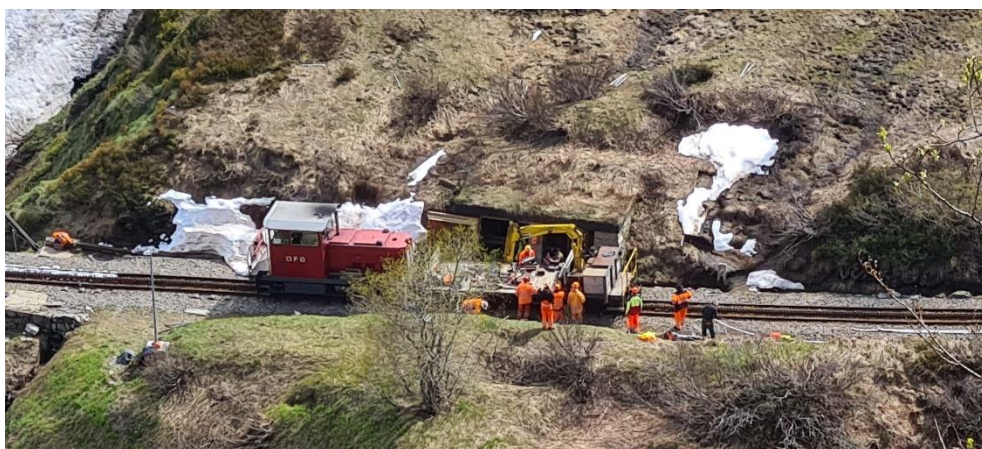
Der Bauzug erreicht um 16.30 Uhr das Windenhaus auf der Bergseite der Steffenbachbrücke.
