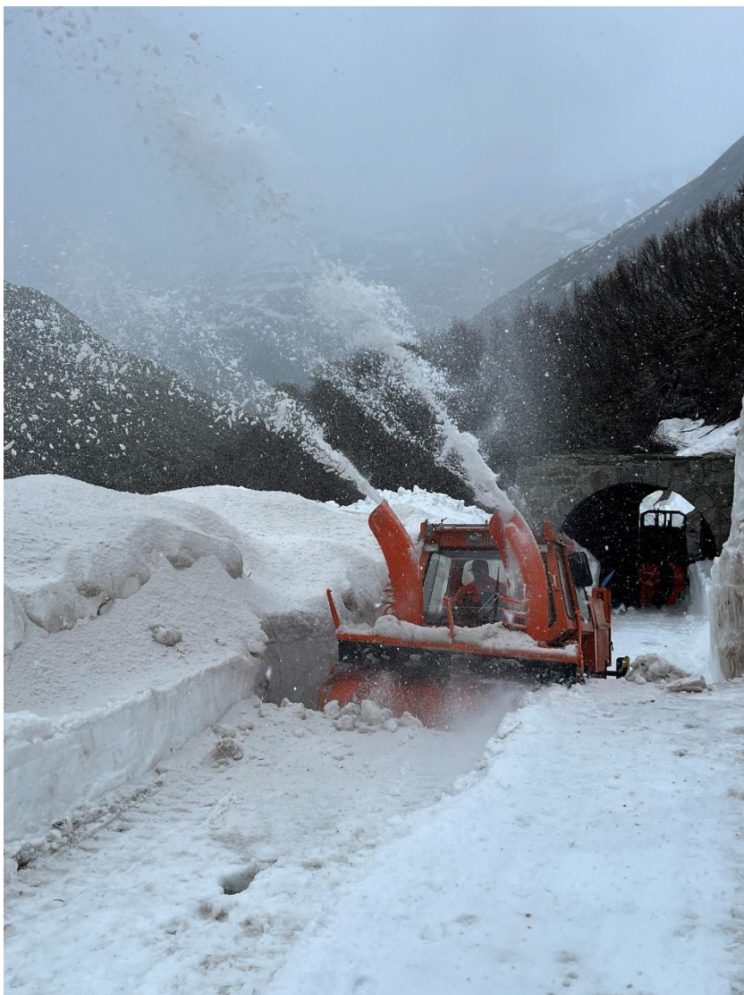
Michael Bühler beim Fräsen durch den stark vereisten Lawinenkegel am bergseitigen Portal des Tunnels 3. Bild: Patrick Smit
