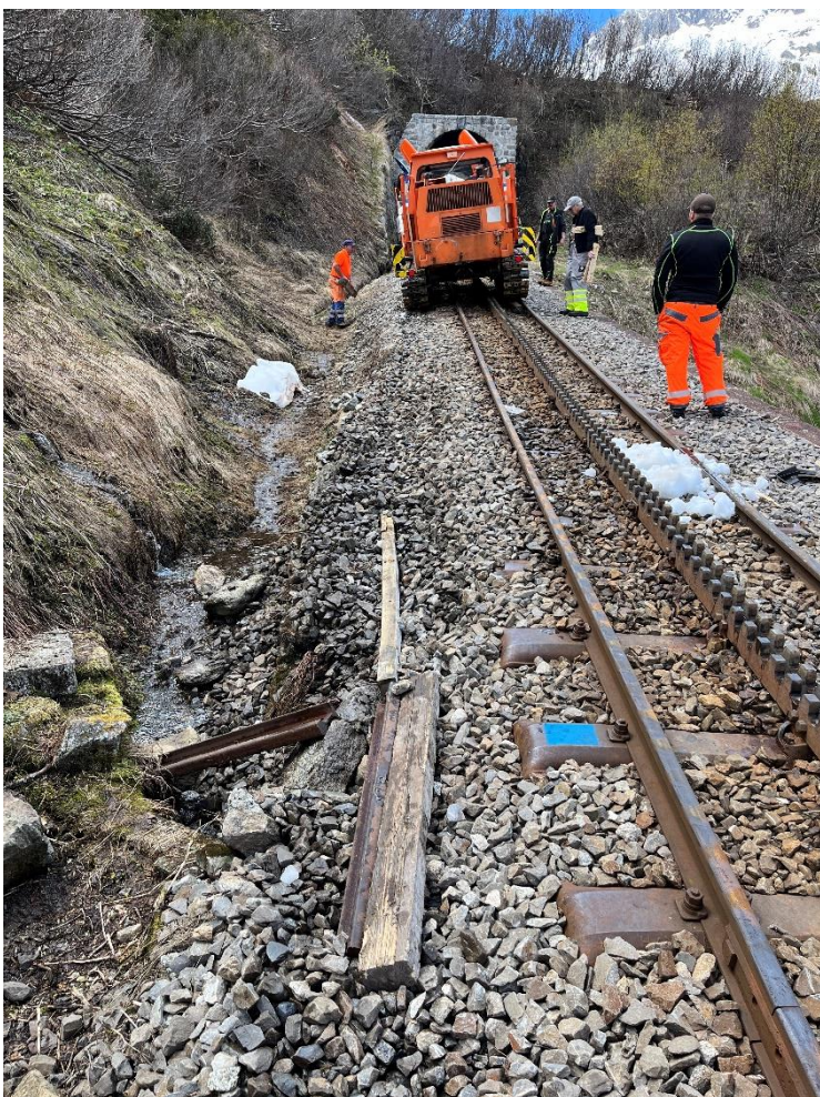
Die INTRAC Raupenfräse auf dem beschwerlichen Weg zum nächsten Einsatzort oberhalb des Tunnels 1.
