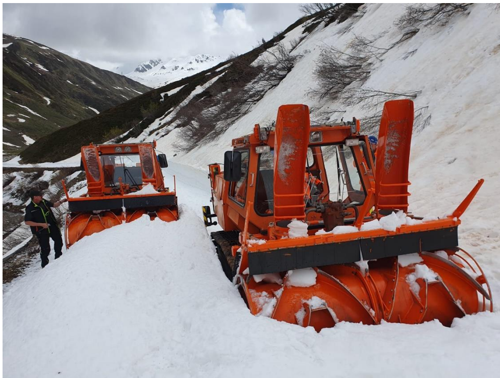
Die beiden INTRAC Raupenfräsen bahnen parallel einen Weg durch die Wächte. In diesem Abschnitt findet sich neben dem Gleis der Fahrweg zur Alp Steinstafel. Bild: Michael Bühler
