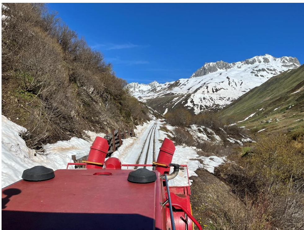
Fahrt am Sonntagmorgen zur vordersten Arbeitsstelle beim Steinstafelviadukt. Vor zwei Wochen lag hier noch bis 2 m Schnee.
