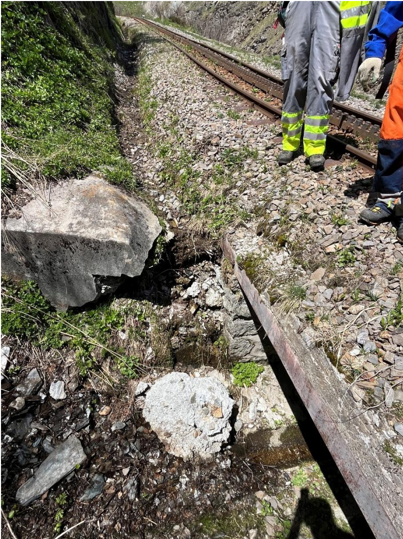
Die bergseitige Versicherung des bergseitigen Widerlagers des Viadukts Chüeplangge hat sich gelöst und muss repariert werden.
