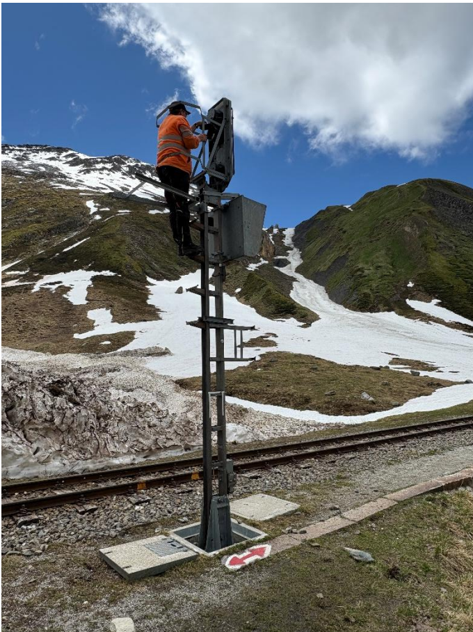
Stephan Stauber wechselt in luftiger Höhe die Glühbirne des Rotsignals des Ausfahrtsignals C des Bahnhofs Muttbach-Belvédère.
