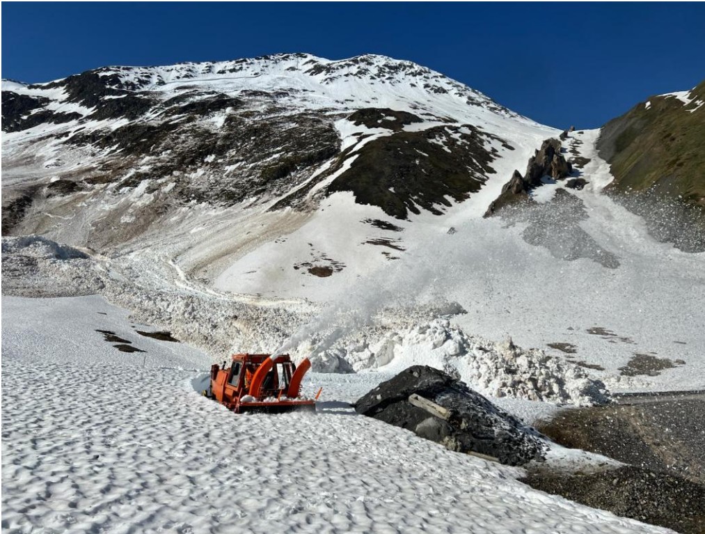
Räumung der Zufahrts- strasse zum Bahnhof Mutt- bach-Belvédère.
