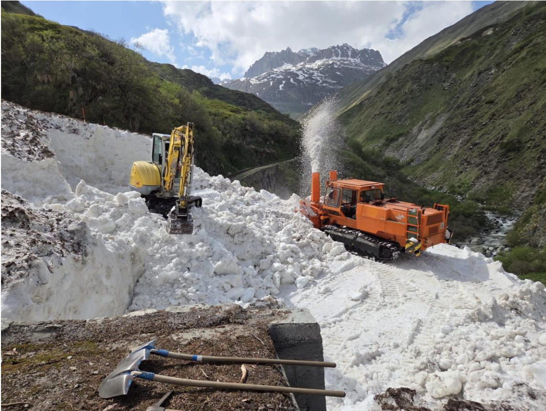
Der Menzi Bagger und die INTRAC Schneefräse auf dem Lawinenkegel vor dem bergseitigen Portal des Altsenntumtunnels I.
