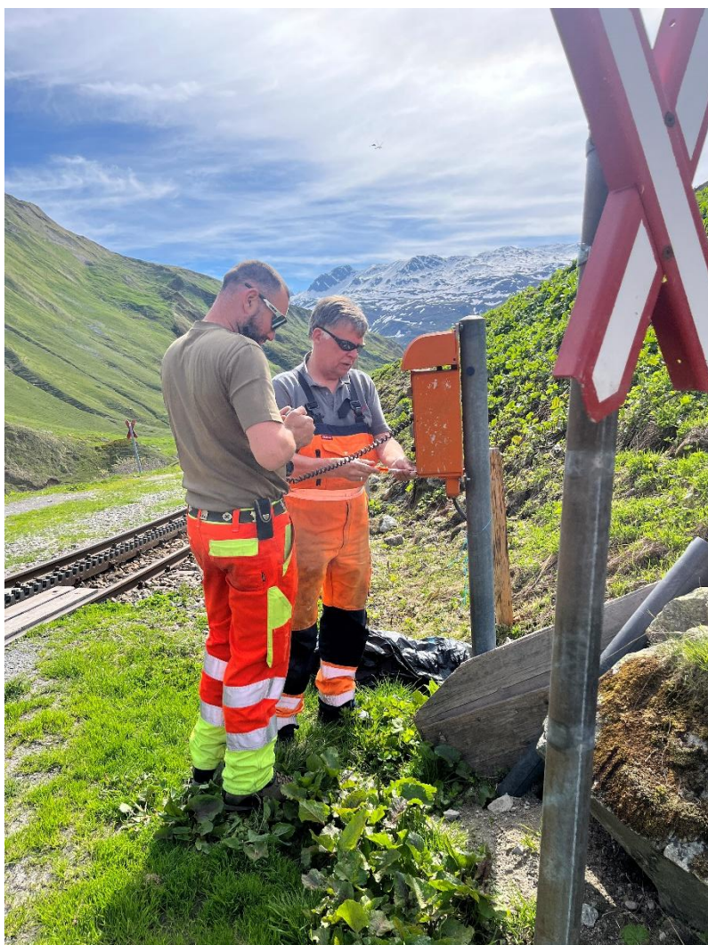
Während der Schmierfahrt prüft Thilo Fock die Streckentelefone und tauscht die Batterien aus.
