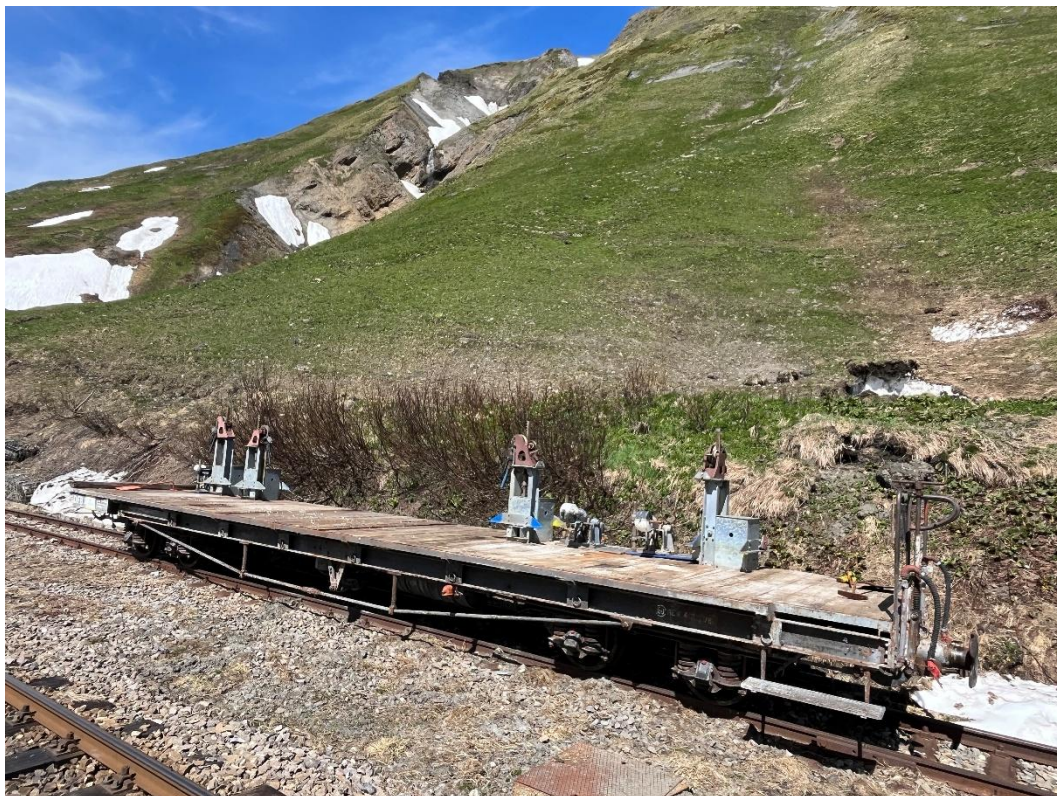
Im Stuppen 21 des Bahnhofs Furka warten die Weichenböcke der Bahnhöfe Furka und Muttbach-Belvédère auf deren Montage nach Pfingsten.
