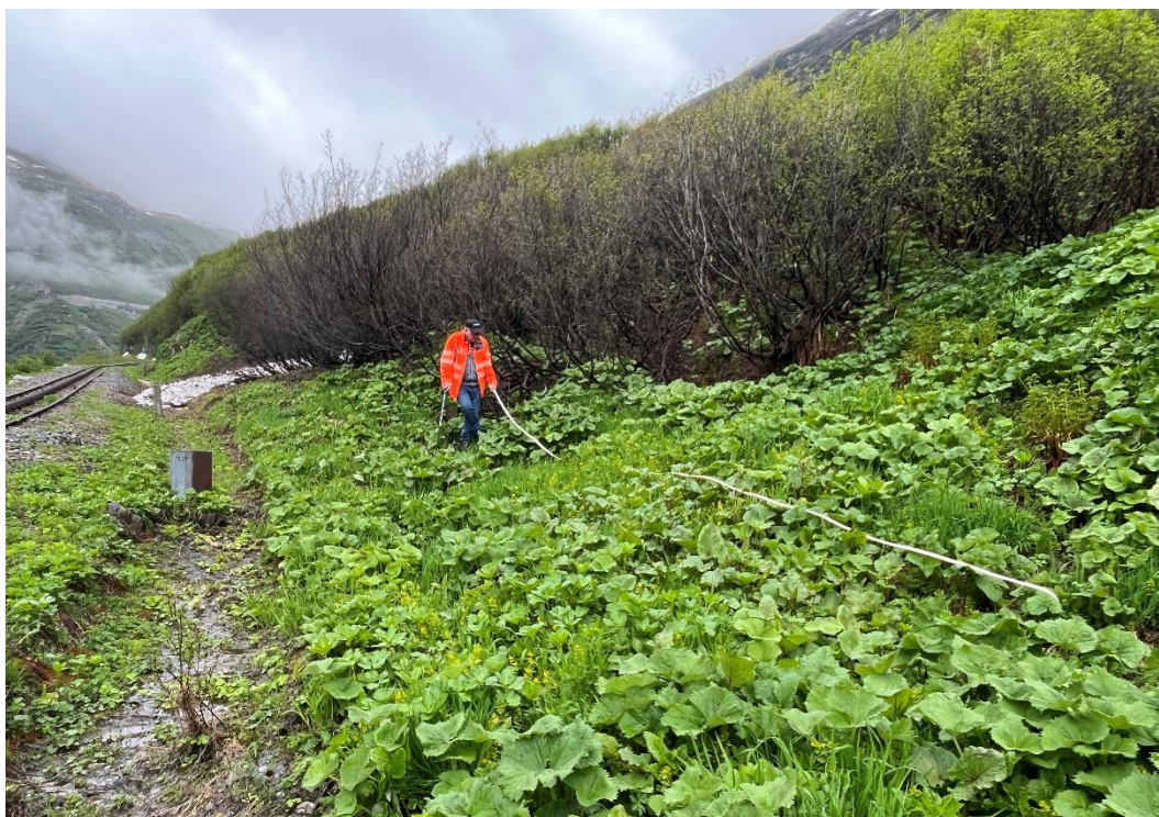
Daniel Feyer beim Ausmessen des Geländes für die Holzkonstruktion, auf welcher 2 Container (Material, Personenunterstand) abgestellt werden. Diese Container werden für die Konstruktion der Bankettversicherungen und den Totalumbau zwischen km 47,5 und km 47,95 während den KW 41, 42 und 43. Bild: Patrick Smit
