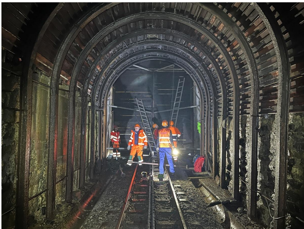
Silvan Bözinger, Roman Cibolini, Bruno Hossmann, Christoph Spinnler und Michel van Wallene beim Öffnen des bergseitigen Tors des Altseentumstafeltunnels II.
