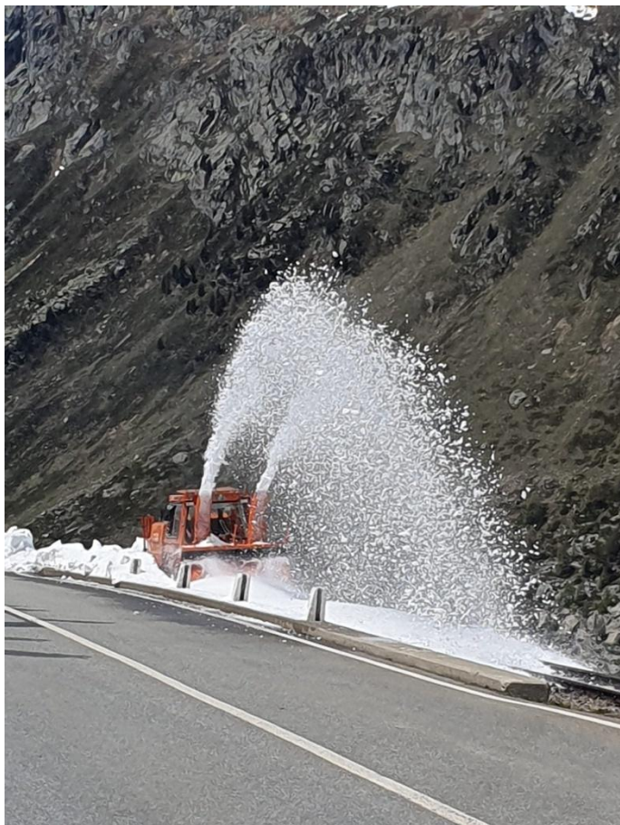
Die INTRAC Raupenfräse im Einsatz kurz vor dem BÜe Furkastrasse. Bild: Michael Bühler
