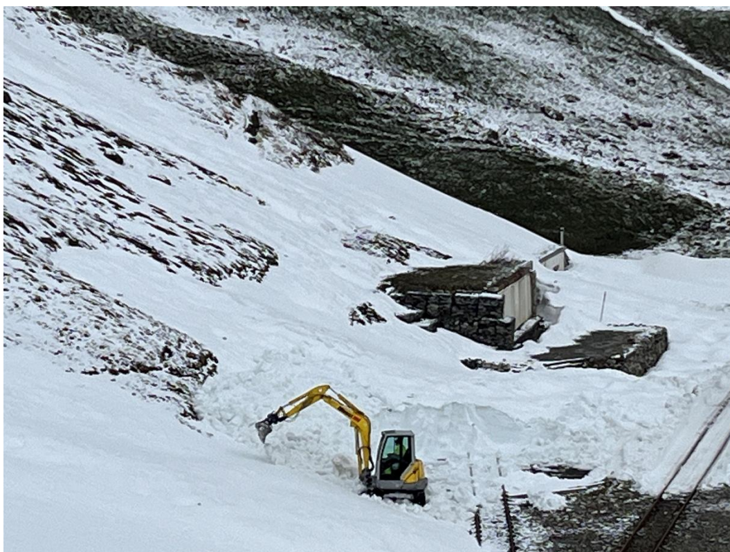
Räumung der Dreh- scheibe. Zwecks effizienter Räu- mung des Vorplatzes des Stationsgebäudes Furka wird die INTRAC Rau- penfräse von Muttbach- Belvédère durch den Scheiteltunnel nach Furka überführt. Bild: Patrick Smit
