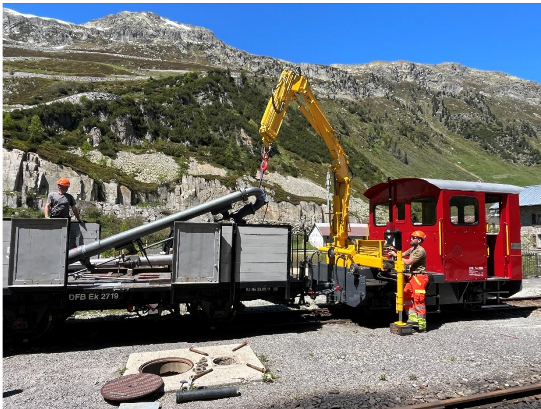
Montage der Wasserkränen des Bahnhofs Gletsch und der Blinksignale des Bahnübergangs Blauhaus.
