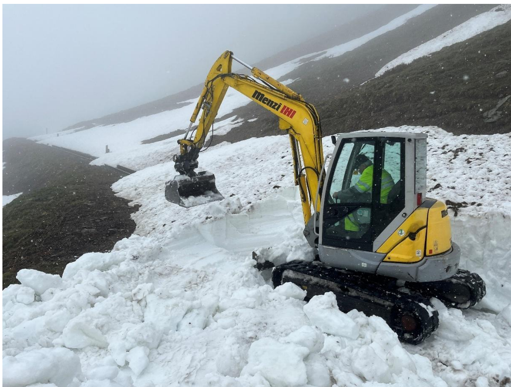
Alexander Briner beim Räumen eines weiteren Lawinenkegels auf Räumhöhe der HGm 51 mit Anbaufräse. Bild: Patrick Smit
