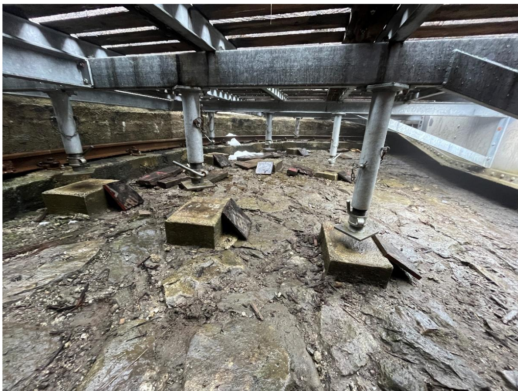
Anheben der Stützen der Drehscheibe des Bahnhofs Furka; ein mühsames Unterfangen auf Knien auf nassem Boden.
