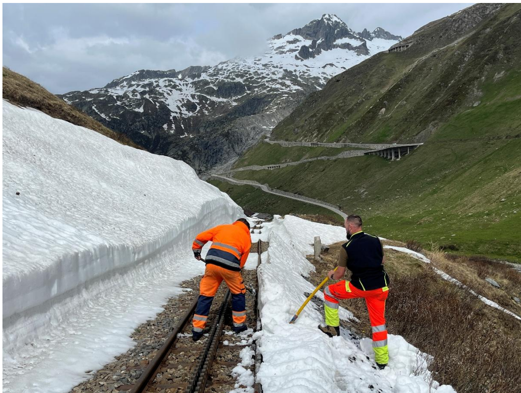
Erkundungsfahrt Richtung Gletsch. Thilo Fock und Martin Wieland müssen zwischen Muttbach-Belvédère und Bahnübergang Furkastrasse den Restschnee aus dem Lichtraumprofil räumen. Bild: Patrick Smit
