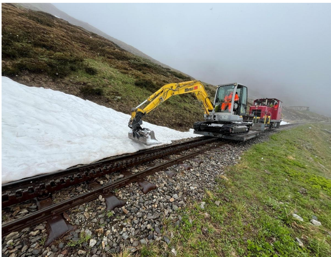
Räumung des nächsten Schneerutsches oberhalb der Sidelenbrücke. Bild: Patrick Smit
