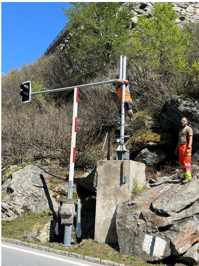
Thilo Fock und Martin Wieland bei der Montage des Bahnübergangs Rotten. Bild: Patrick Smit
