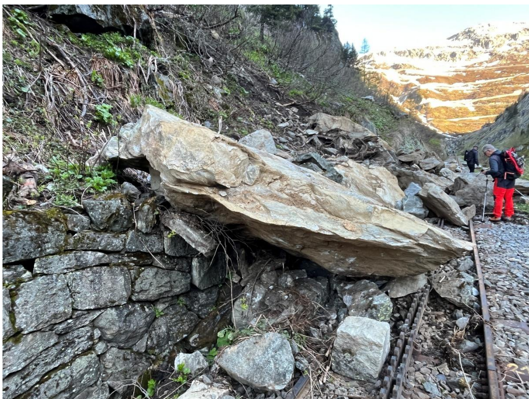
Die beschädigte Trockenmauer. Bild: Patrick Smit
