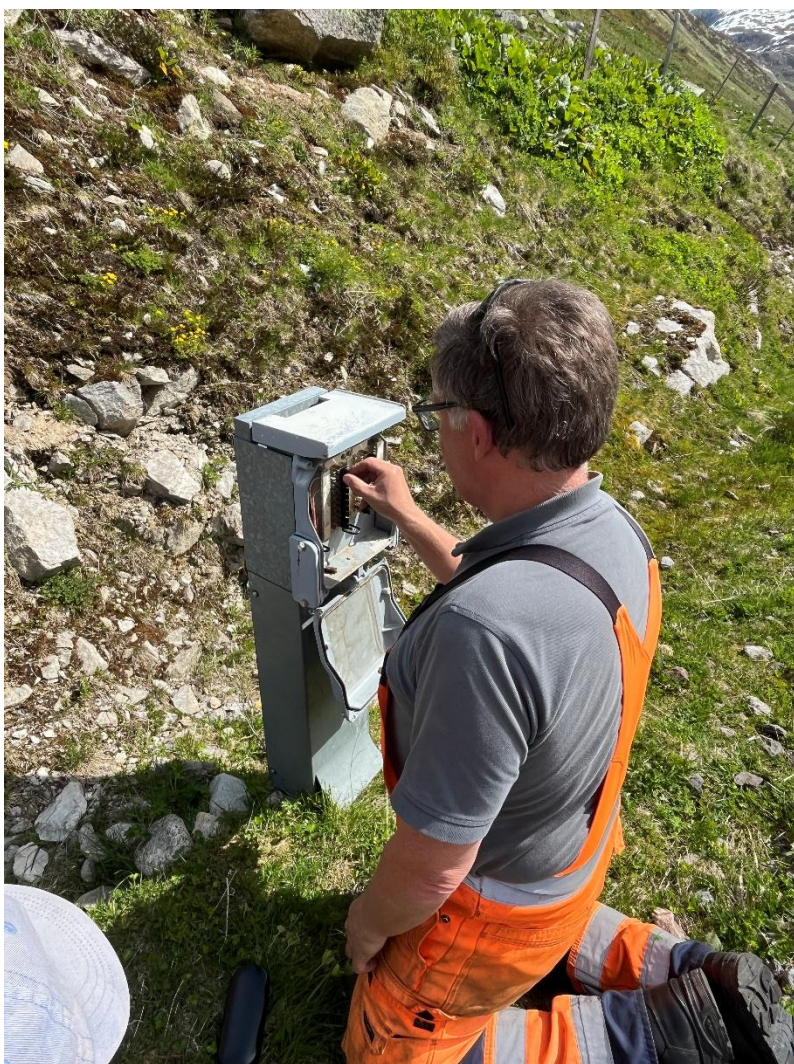
Thilo Fock kontrolliert den Verteilkasten für die Streckentelefone bei der Sidelenbrücke. Bild: Patrick Smit
