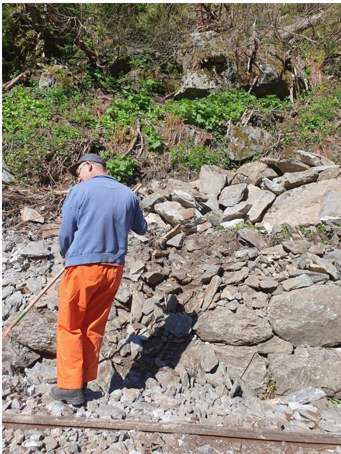
Beat Brehm bei der Feinräumung bei der vom Felssturz demolierten Trockenmauer. Bild: Bruno Zimmermann
