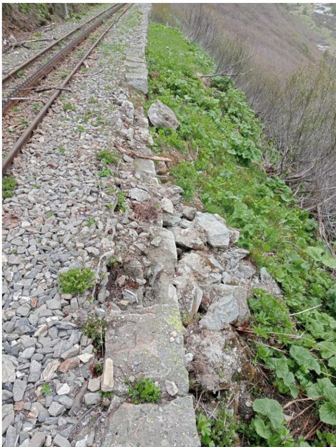
Schadenstelle unterhalb der Hilfsbrücke. Bild: Martin Wieland
