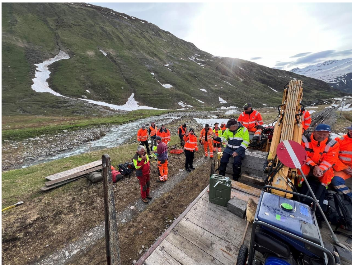
29.5.2024 Ablad der Gleissanierungs-Gruppe oberhalb der Zahnstangeneinfahrt Tiefenbach Seite Furka. Bild: Patrick Smit
