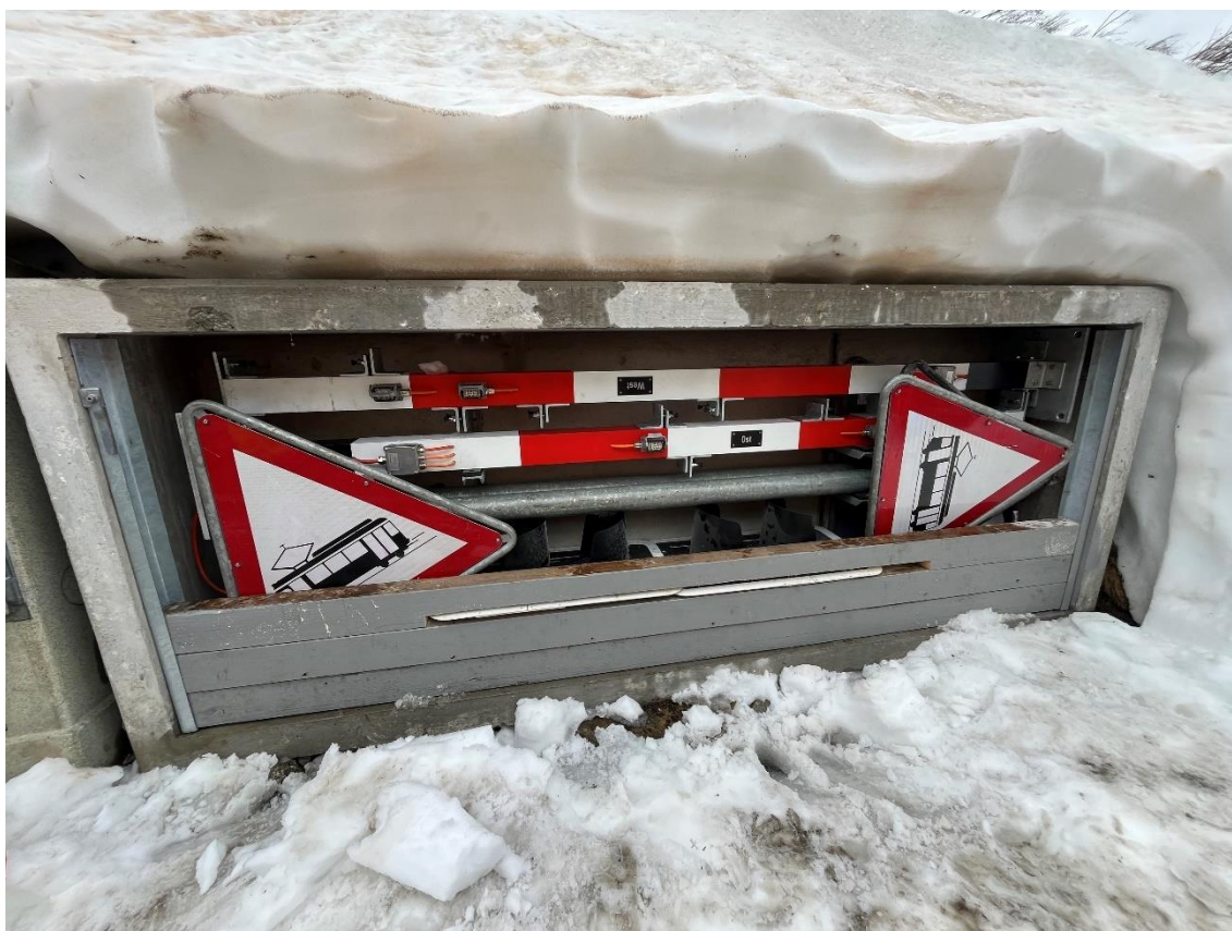
Dank des winter- und lawinensicheren Unterstands von Marcel Gwerder können die Signale des Bahnübergangs Furkastrasse nun direkt beim Bahnübergang überwintert werden.
