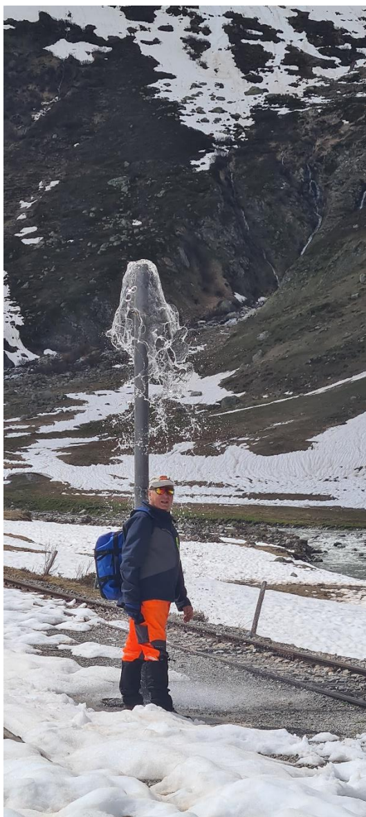
Niklaus Mayer und Beat Mühlemann graben die Wasserfassung des Bahnhofs Tiefenbach aus und nehmen die Wasserversorgung in Betrieb.
