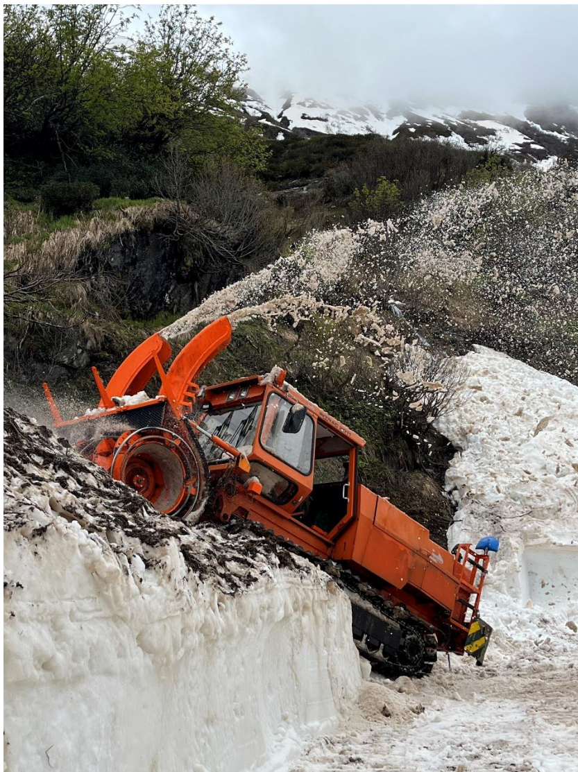
Stephan Stauber fräst sich in den Lawinenkegel am bergseitigen Portal des Tunnels 2.
