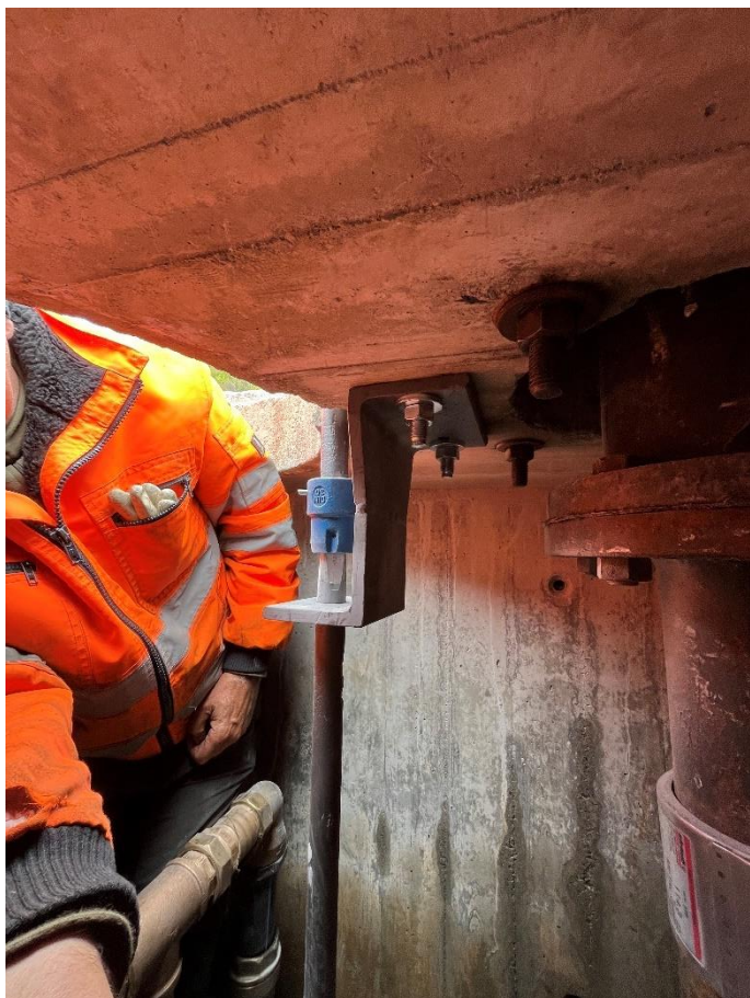
Dank der neuen Konstruktion muss beim Einwintern nur noch die Spindel oberhalb der blauen Muffe ausgebaut werden. Patrick Smit dokumentiert die neue Konstruktion in der 60-seitigen Ein- und Auswinterungsliste. Bild: Patrick Smit
