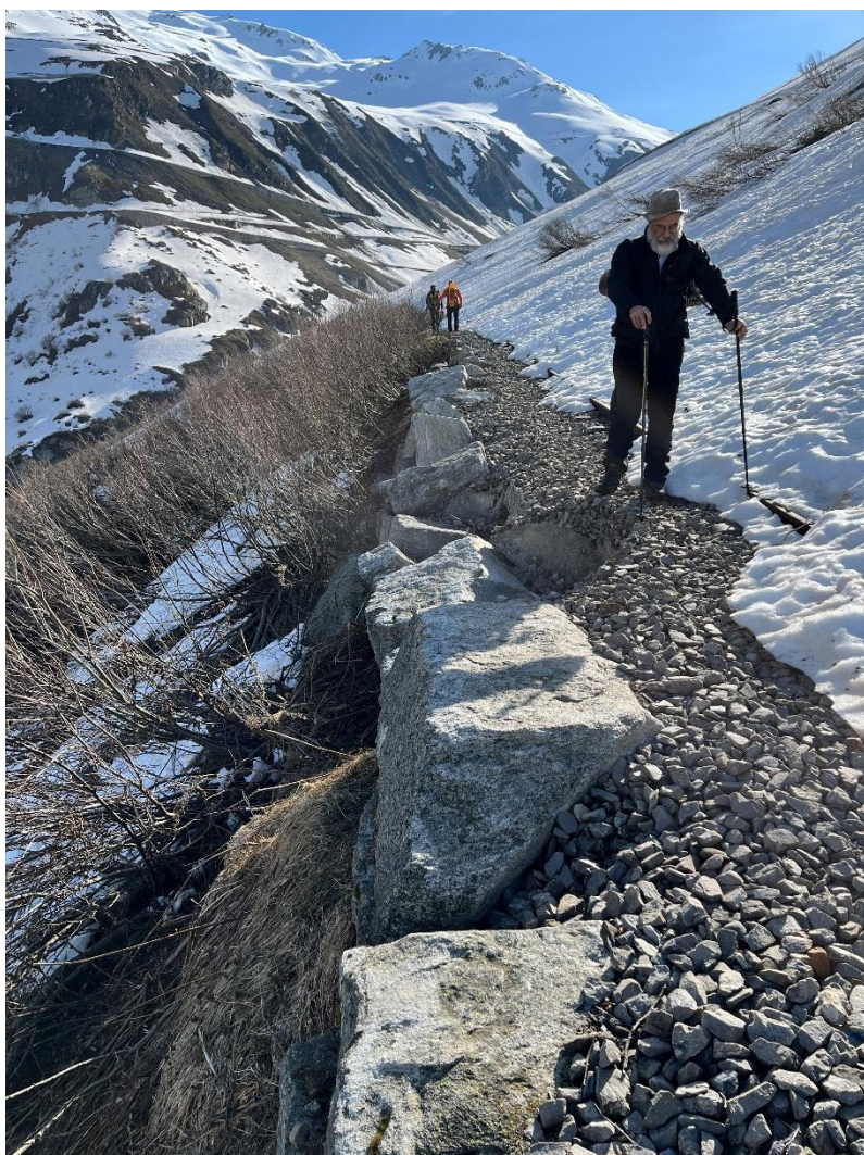
Schadstelle bei km 48,0. Bernhard Lang mar- kiert mit den Stöcken die talseitige Schiene und 50 cm ab Schiene.
