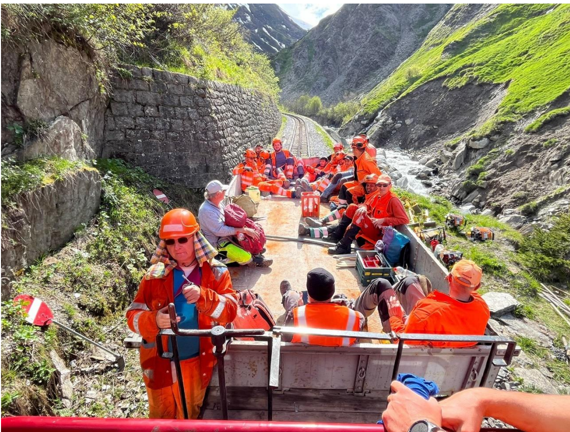
Zwischen Tunnel 3 und Wilerbrücke werden die Lehrlinge von LOGIN aufgeladen und zusammen mit dem Auswinterungsteam nach Realp überführt. In diesem Streckenabschnitt haben die Lehrlinge den Schotter gestopft, der am Vortag mit dem grossen Schotterwagen der DFB eingebracht wurde. Bild: Peter Fietz
