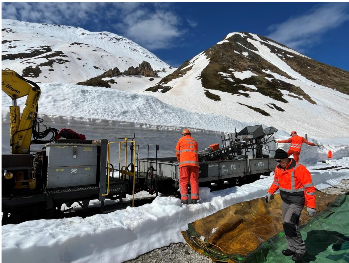
... montieren Hans und Andreas Kessler sowie Guido Treppe die Sicherungsanlagen des Bahnhofs Muttbach-Belvédère. Bild: Patrick Smit
