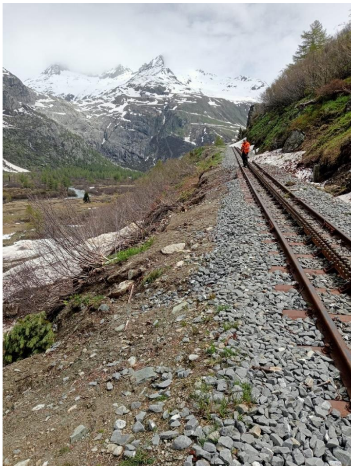
Patrick Smit steht unmittelbar an der Schadenstelle. Bild: Martin Wieland
