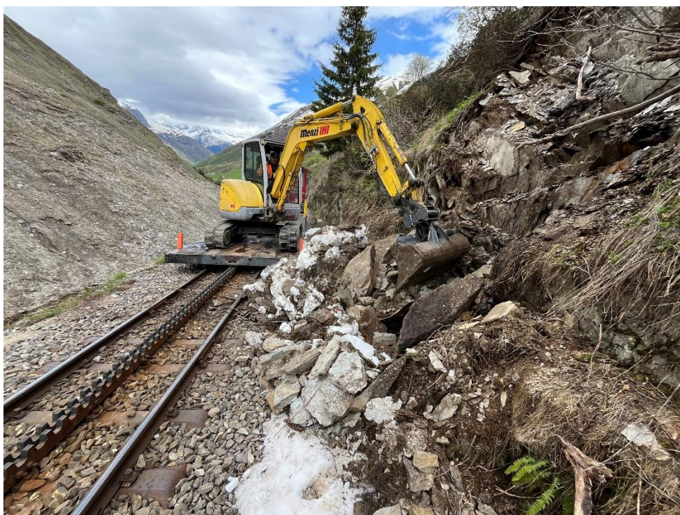
Oberhalb der Wilerbrücke räumt Stephan Stauber mit dem Menzi Bagger einen Felssturz, der das Lichtraumprofil verletzte. Zwischen der Wilerbrücke und Tunnel 3 sind die Wassergräben stellenweise mit Erdreich und Schutt verfüllt.
