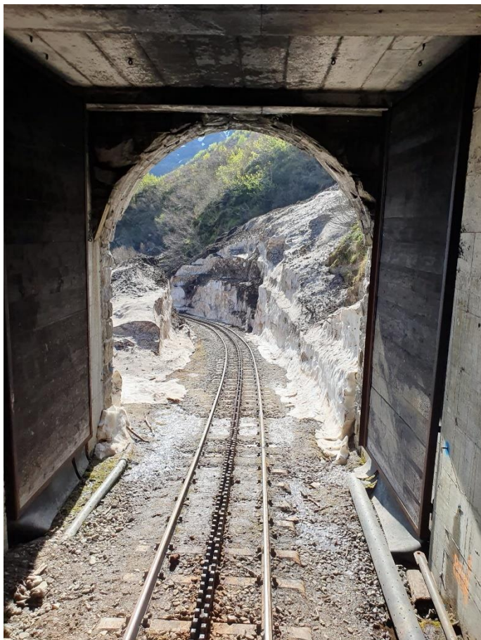
Blick vom talseitigen Portal des Tunnels 2 Richtung Tunnel 3. Vor etwas mehr als einer Woche kämpften wir hier durch meterhohe Geröll-, Erd- und Schneemassen.
