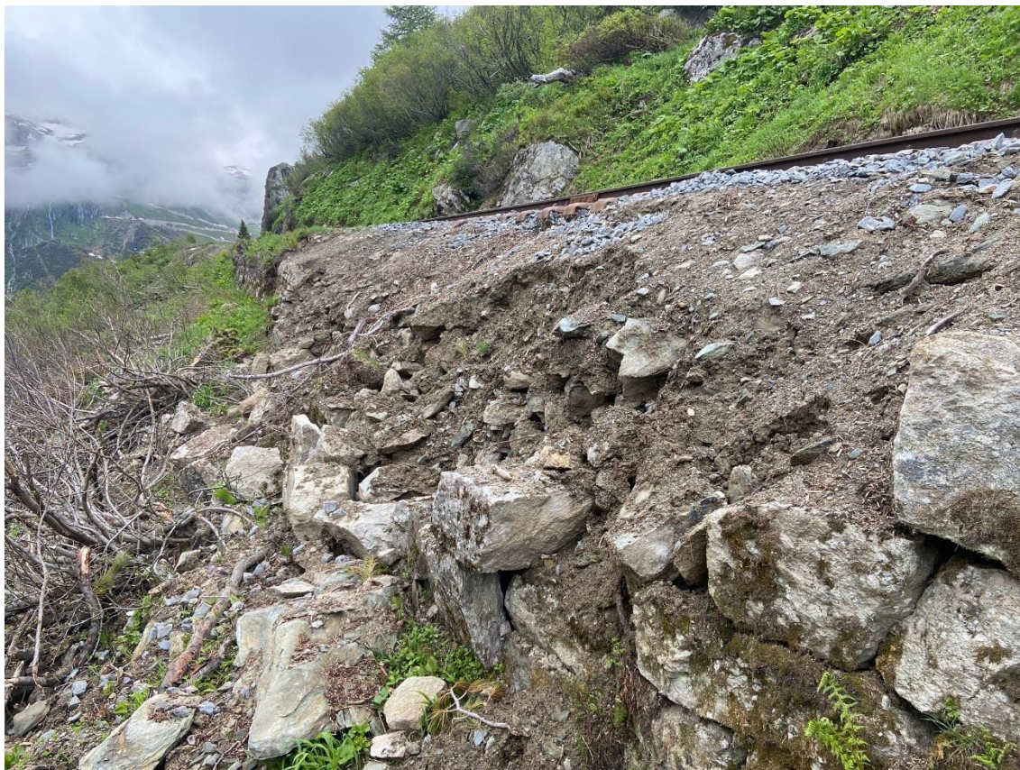
Die von einer Lawine beschädigte Trockenmauer oberhalb der bergseitigen Zahnstangeneinfahrt Gletsch. Bild: Tobias Hardmeier
