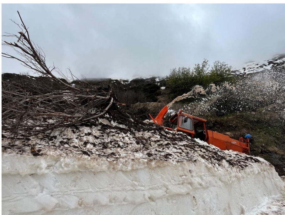
Ein grosser Erlenstrauch und Felsblock verunmöglicht ein Weiterkommen mit der INTRAC Schneefräse.
