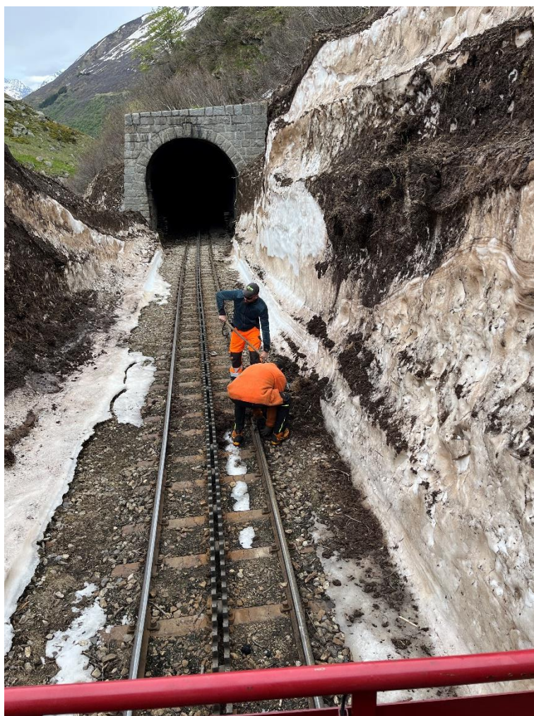
Mit dem Abschmelzen des Schnees beidseits der Gleise fällt immer wieder Erdreich und Geröll auf das Bahntrasse. Zudem bilden die auf den Lawinenkegel liegenden Felsblöcke während der Schneeschmelze eine latente Gefahr für das Bahntrasse. Bild: Patrick Smit
