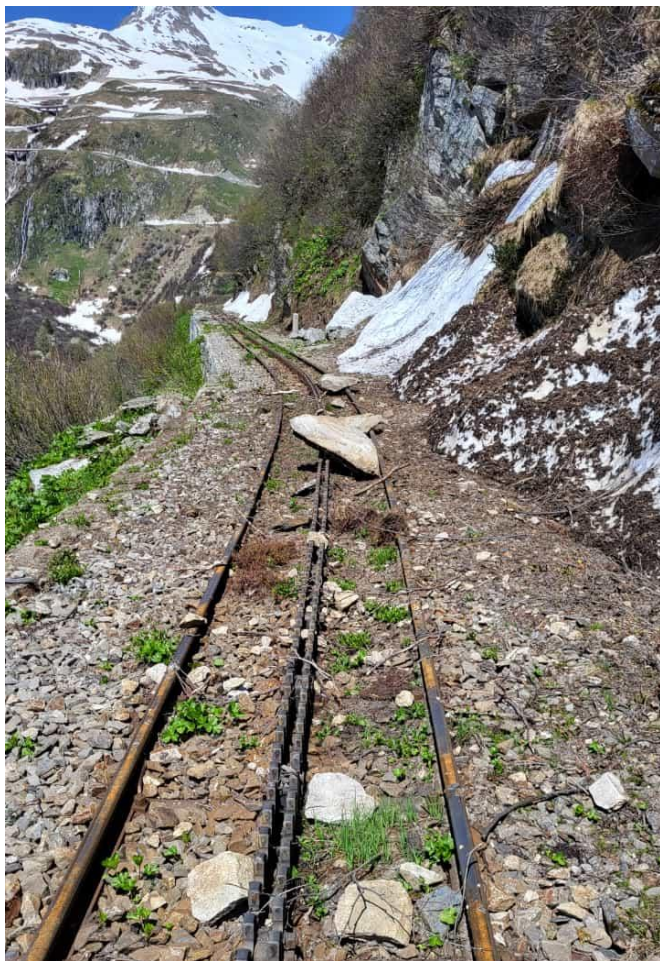
Geröll noch und noch zwischen Gletsch und Bahnübergang Furkastrasse.
