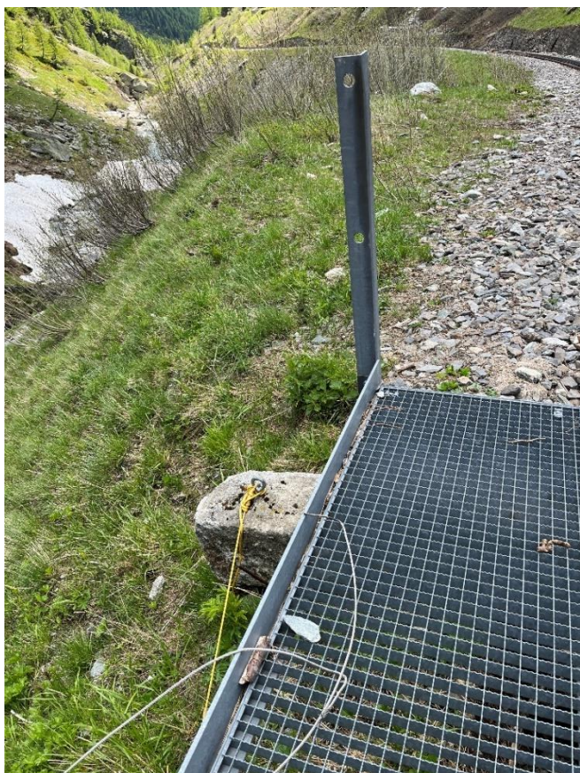
Leider können wir die Führungsseile des Geländers des Rottenviadukts nicht abspannen, weil die Abspannvorrichtungen unauffindbar sind. Auch nach telefonischen Abklärungen mit einem Kollegen des Einwinterungsteams bleiben die Abspannvorrichtungen unauffindbar. Da die Drahtseile nicht abgespannt sind, fädeln wir die Drahtseile wieder aus den Geländerpfosten aus.
