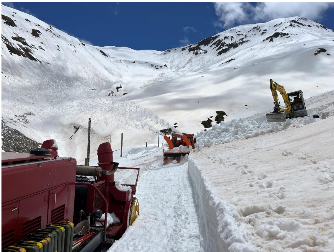
Nach der Räumung des Gleis 2 beginnen Martin Wieland (Bagger) und Stephan Stauber (INTRAC Raupenfräse) mit der Räumung des Vorplatzes des Bahnhofs Furka.
