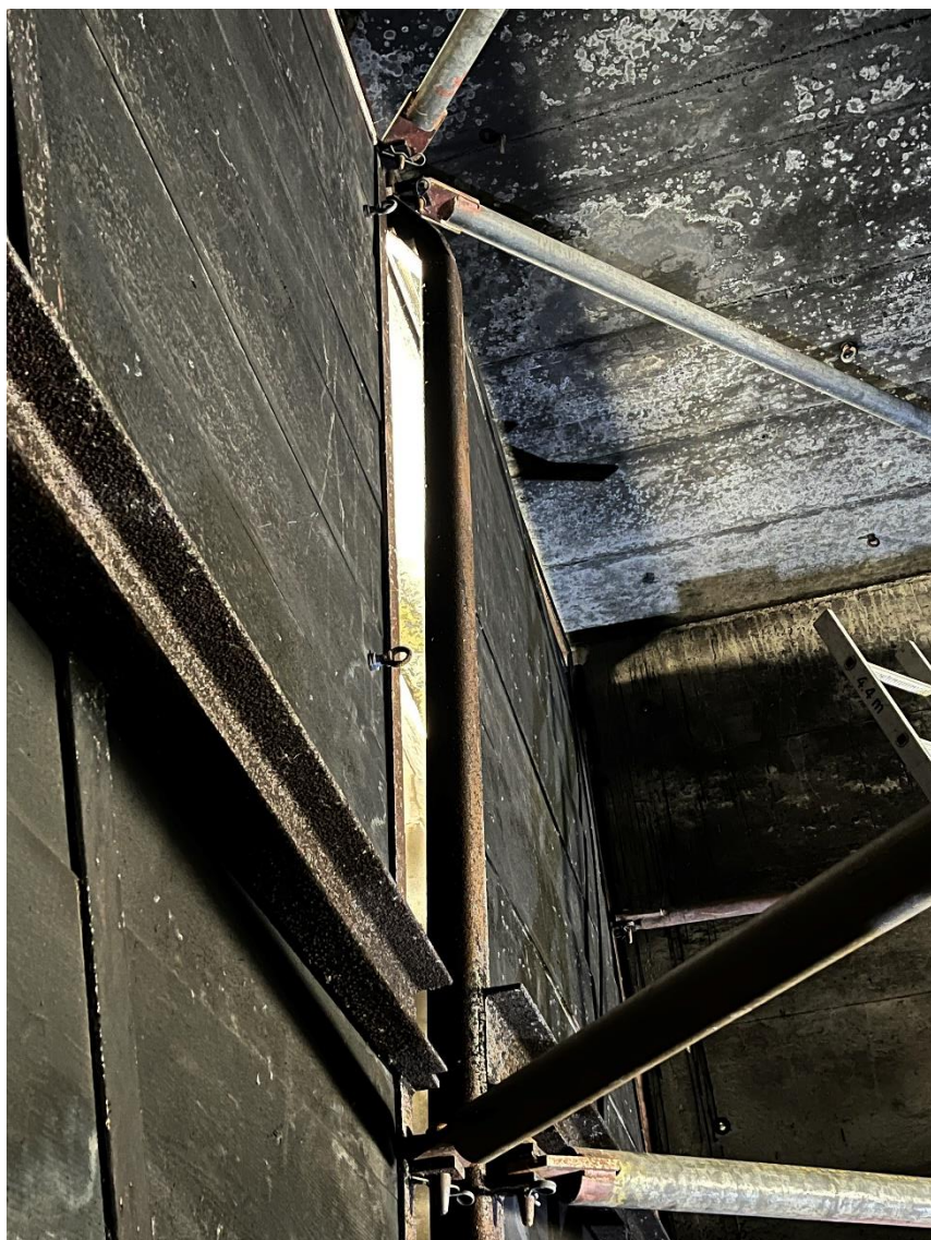
Eine Lawine hat den talseitigen Flügel des bergseitigen Tors des Tunnels 1 eingedrückt. Der oberste Spriess wurde hierbei verbogen. Bild: Patrick Smit,
