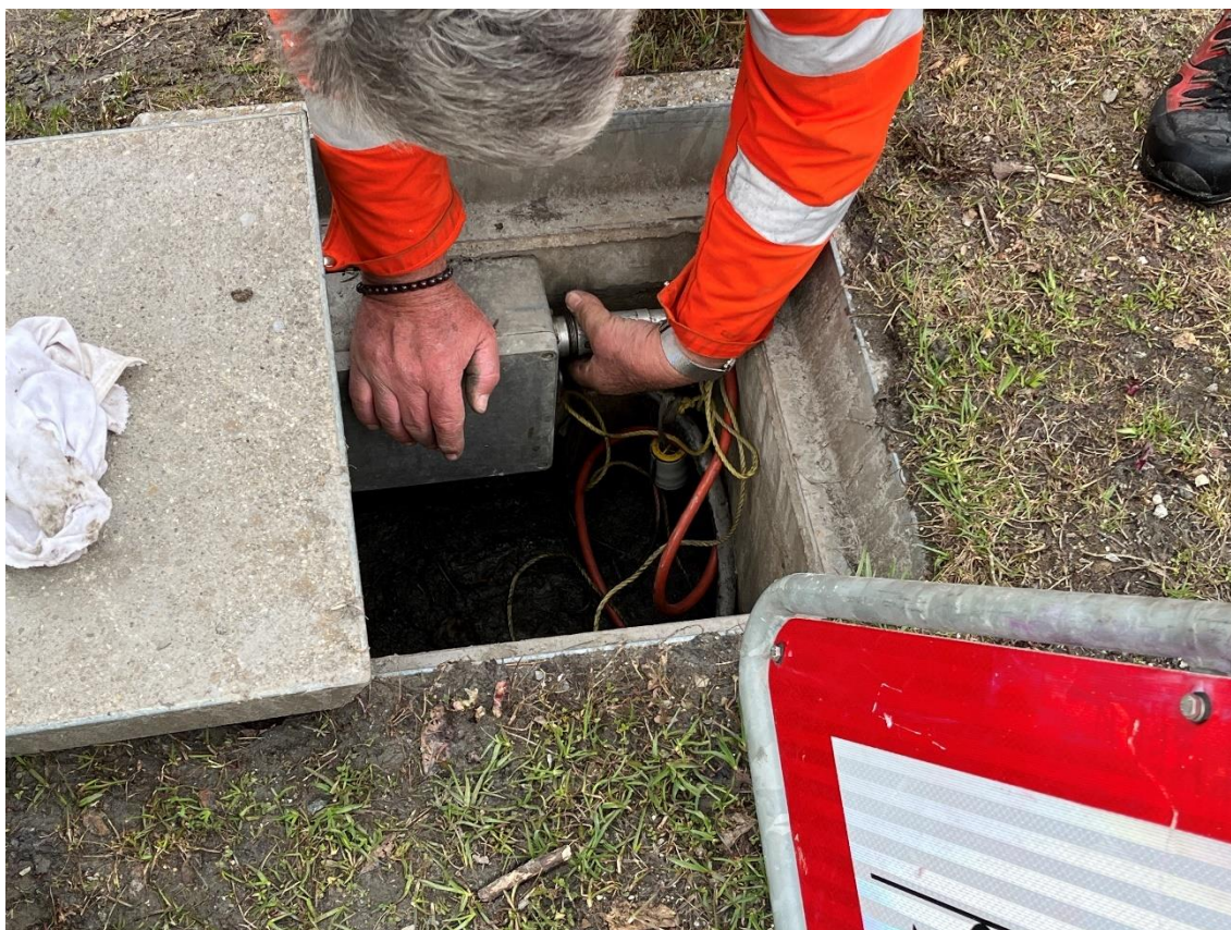
Guido Treppe schliesst die Signale an der Ortsanlage an.
