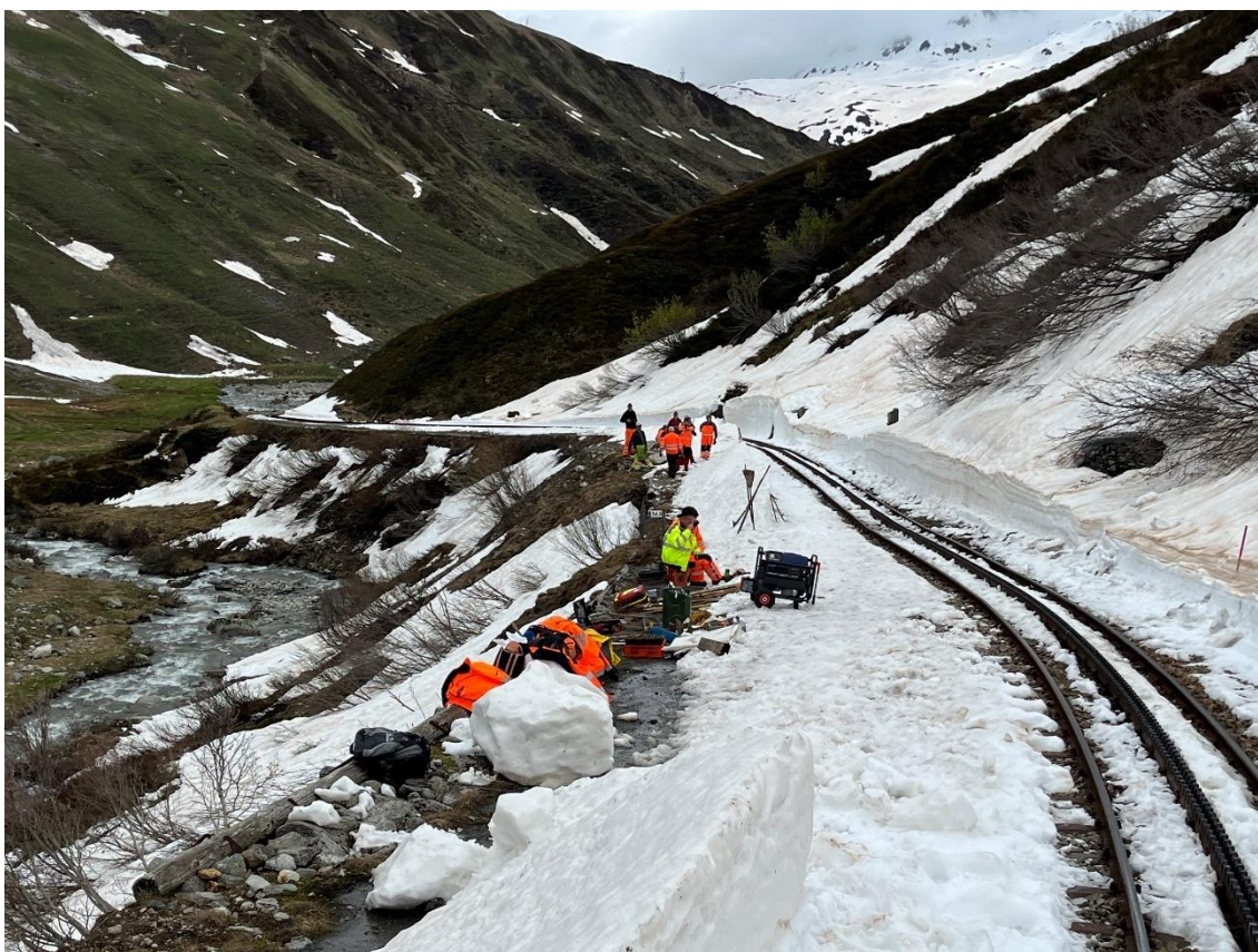
Die Gleissanierungsgruppe wartet im Fluchraum die Durchfahrt des Bauzuges zwischen Tiefenbach und Steinstafelviadukt ab.
