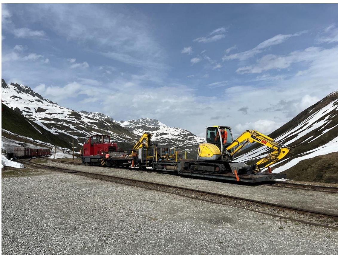
Zum Glück ist der Bagger in Muttbach-Belvédère und der Tiefgänger in Furka abgestellt. Oliver Rusterholz (Lokführer) und Marcel Gwerder (Baggerführer) überführen den Bagger von Muttbach-Belvédère nach Furka. Bild: Patrick Smit
