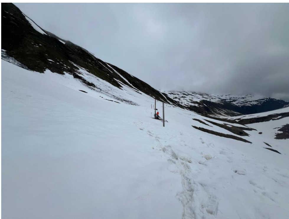
Niklaus Mayer, Matthias Wenger und Luc Wullschleger messen die Gleisachse zwischen Tiefenbach und Furka ein und markieren diese in regelmässigen Abständen mit Holzpflocken.
