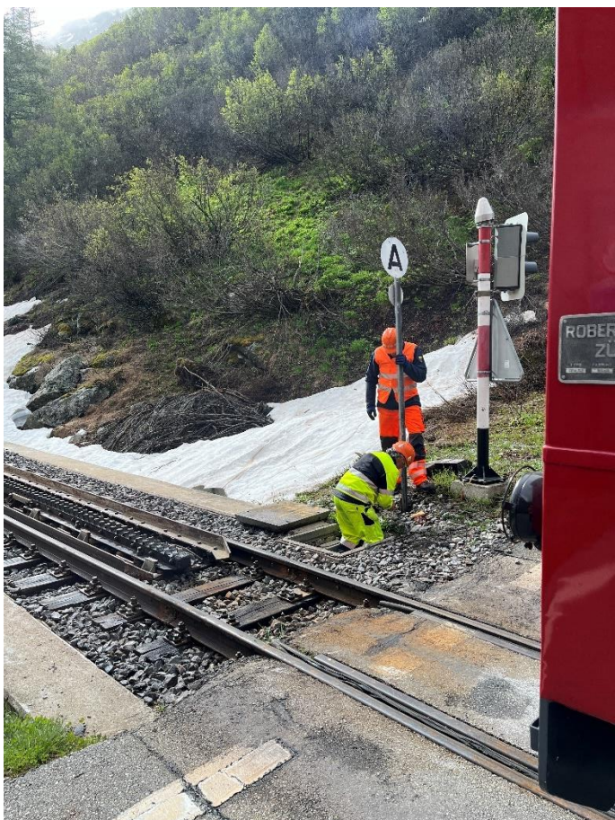
Beat Mühlemann und Werner Spahni montieren das A/E-Signal bei der bergseitigen Zahnstangeneinfahrt von Gletsch. Bild: Patrick Smit
