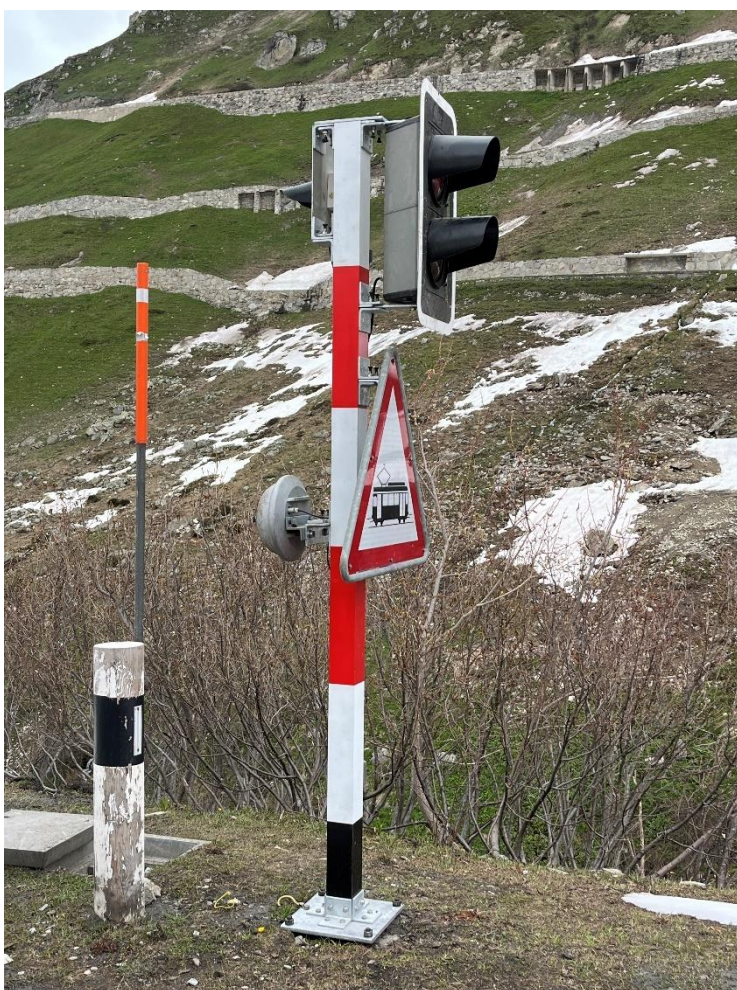
Das neue bergseitige Signal des Bahnübergangs Furkastrasse.
