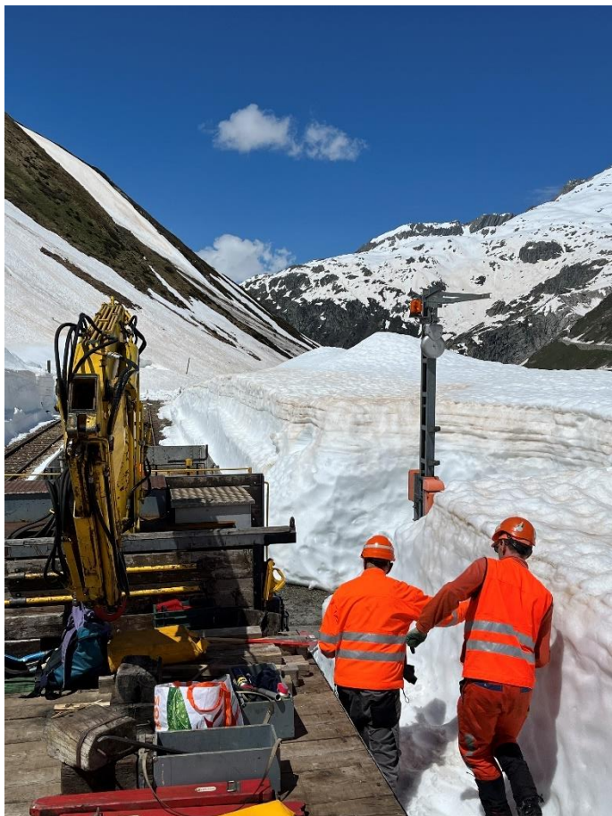
Der Tastenkasten des Bahnhofs Muttbach-Belvédère ist montiert.
