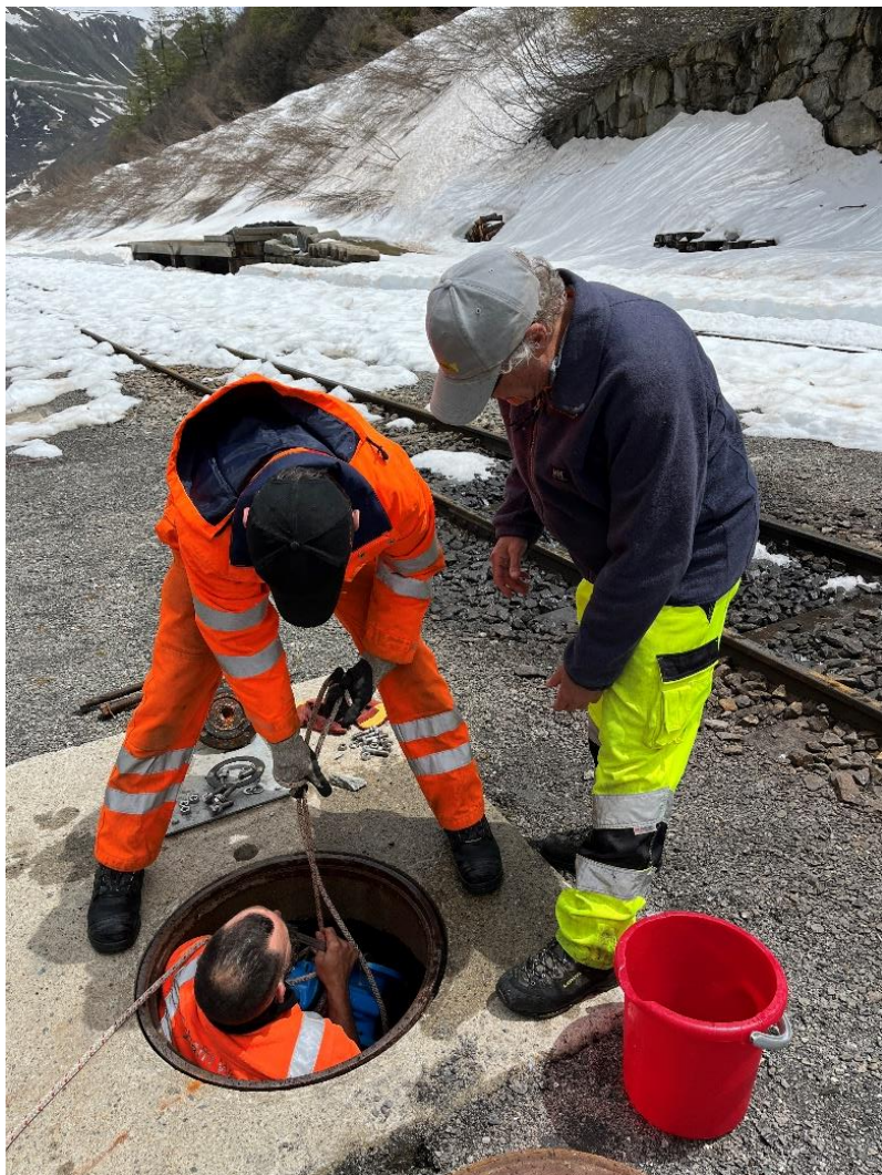
Einbau des revidierten Schiebers des Wasserkrans 1 des Bahnhofs Gletsch. Bild: Patrick Smit
