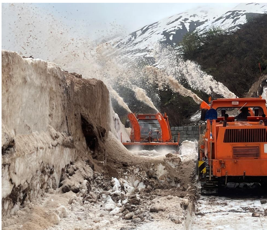
Die INTRAC Raupenfräsen im Regen zwischen Tunnel 3 und Tunnel 2. Bild: Patrick Smit
