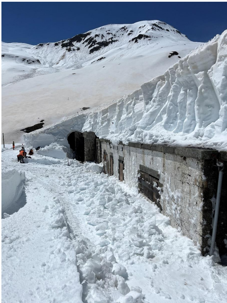
Gut sichtbar die 3 m mächtige Schneeschicht auf dem Bahnhofsgebäude Furka.
