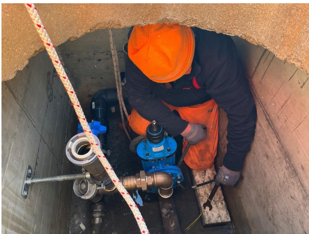
Die Arbeit im engen Schacht des Wasserkrans 1 ist nicht gerade angenehm. Bild: Patrick Smit
