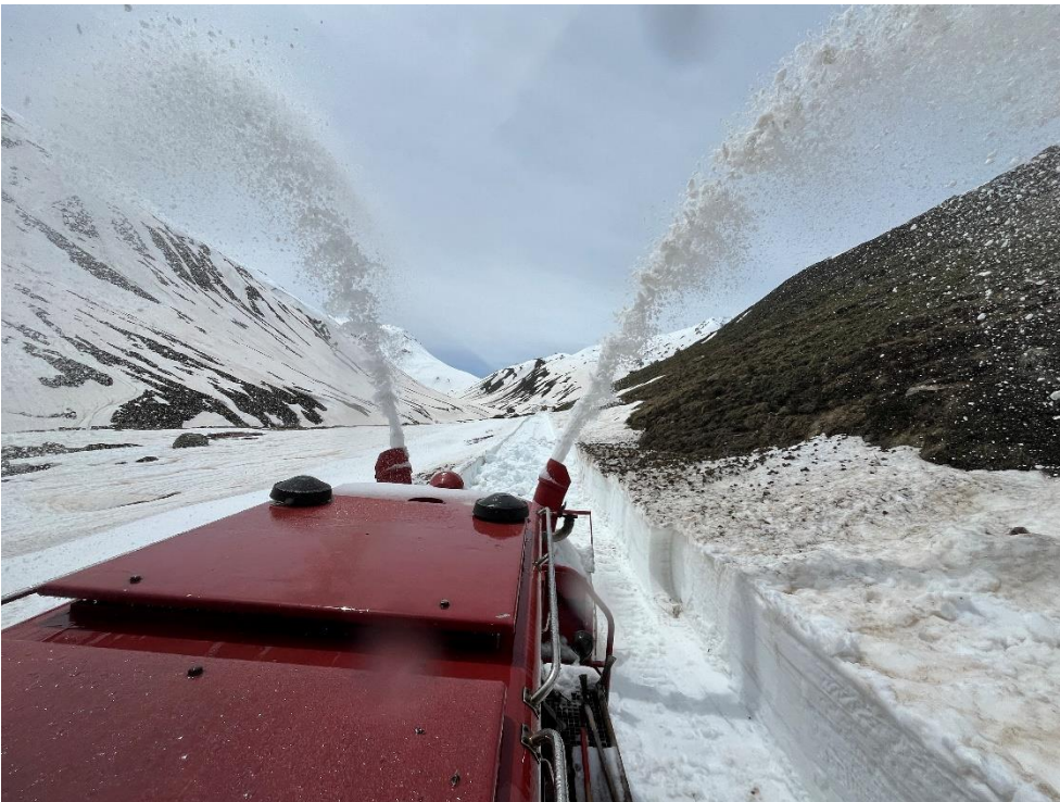
Langsam fräst sich die HGm 51 mit Anbaufräse vom Steinstafelviadukt Richtung Si- delenbachbrücke. Bild: Patrick Smit
